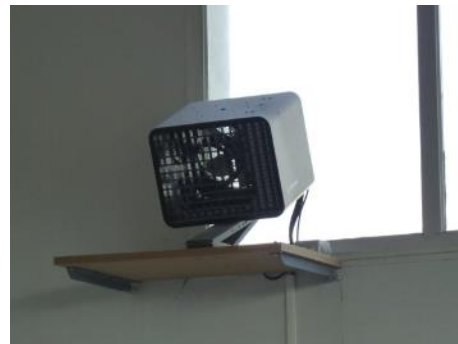
Aérotherme dans la salle de danse
